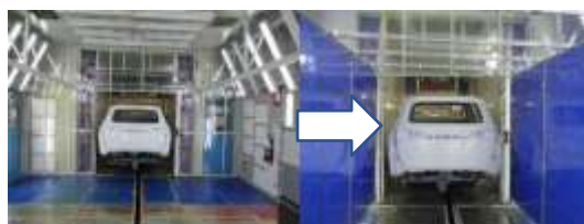
Gambar 4. Kondisi Sebelum dan Sesudah Instalasi Dust Catcher
